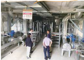
JICA無償資金協力事業によって導入された水道設備の視察
