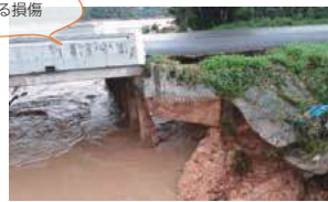
洪水による損傷
