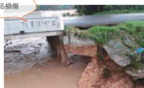
洪水による損傷
